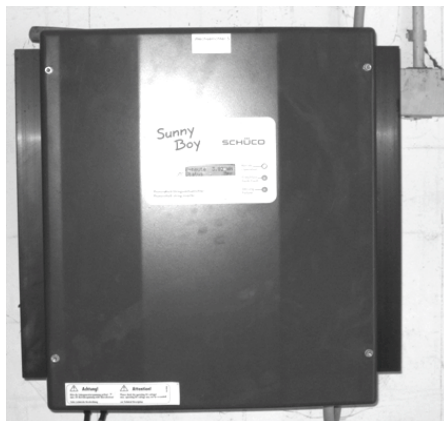
Рис. 3.10. Типовой инвертор фотоэлектрических батарей
